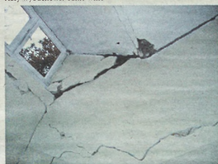
Pęknięcia na klatce schodowej
