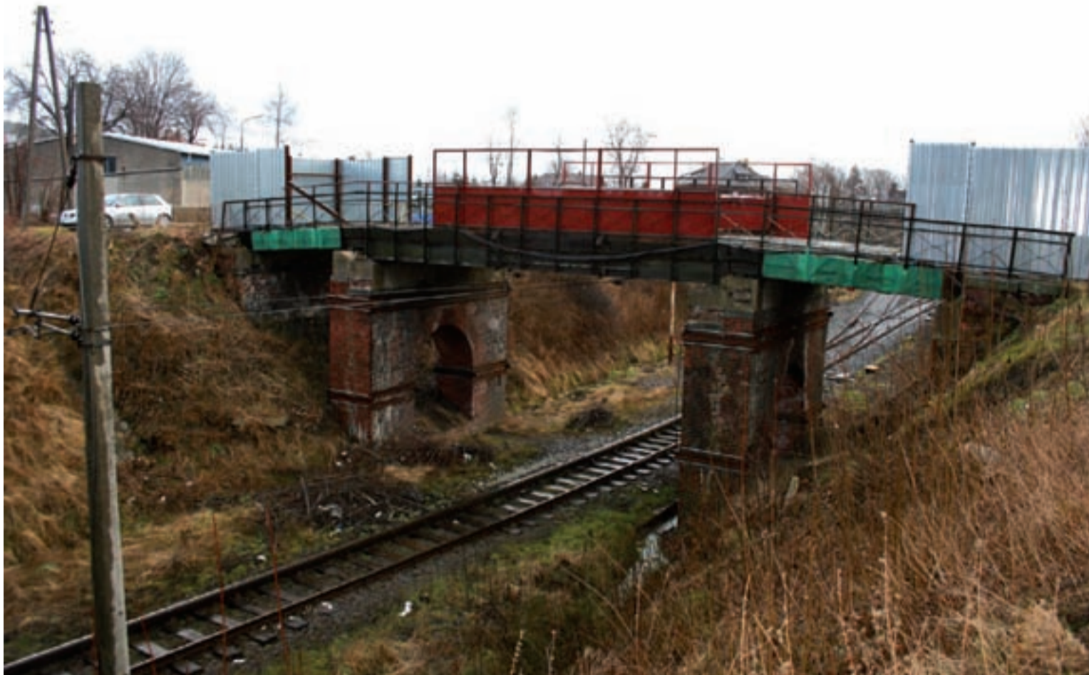
Piechowice muszą zająć się rozbiórką dwóch wiaduktów nad linią kolejową Jelenia Góra - Szklarska Poręba. Nie rezygnują jednak z sądowej drogi udowodnienia, że obiekty nie należą do miasta.
