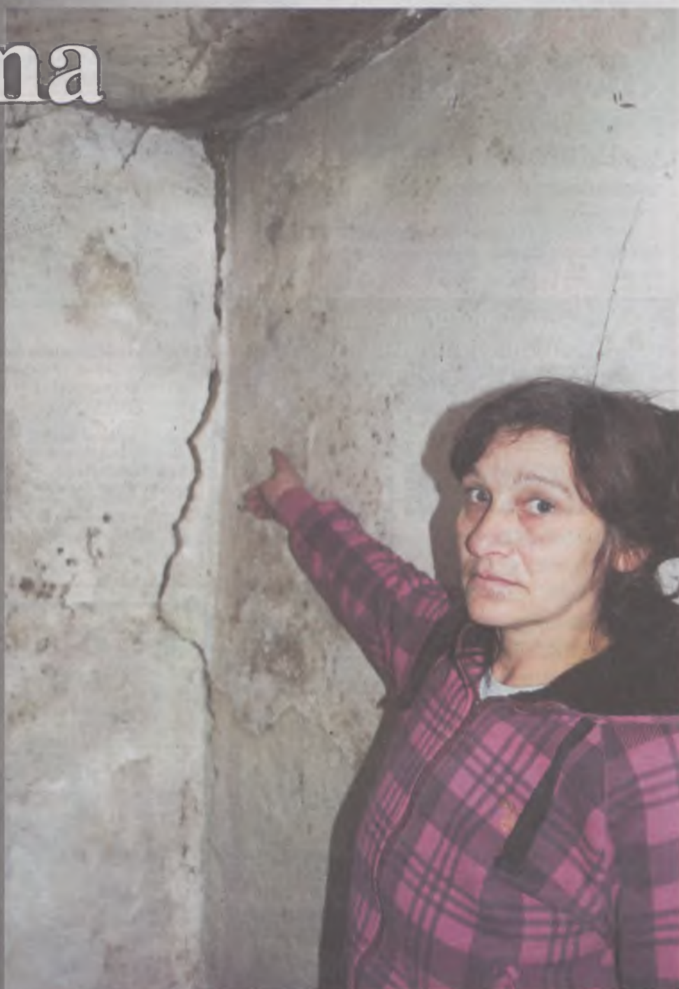
Po odpadnięciu zewnętrznej ściany szczytowej pękają ściany w pomieszczeniach
