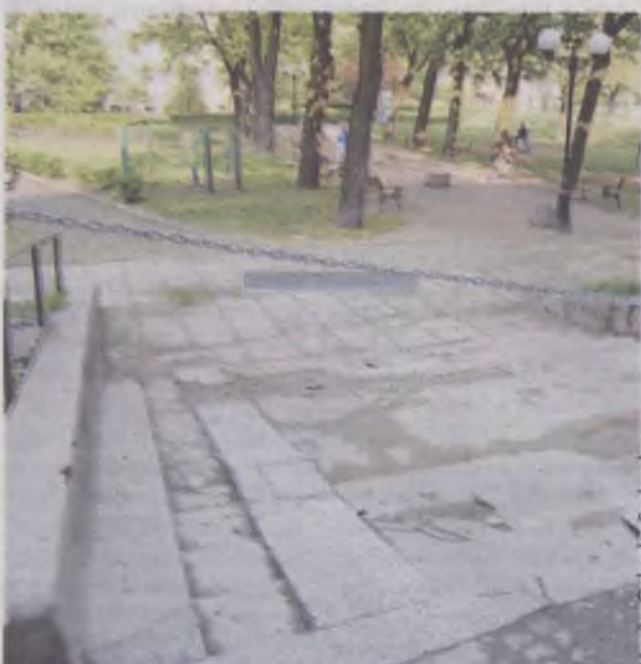
Schody są bardzo zniszczone i niebezpieczne
