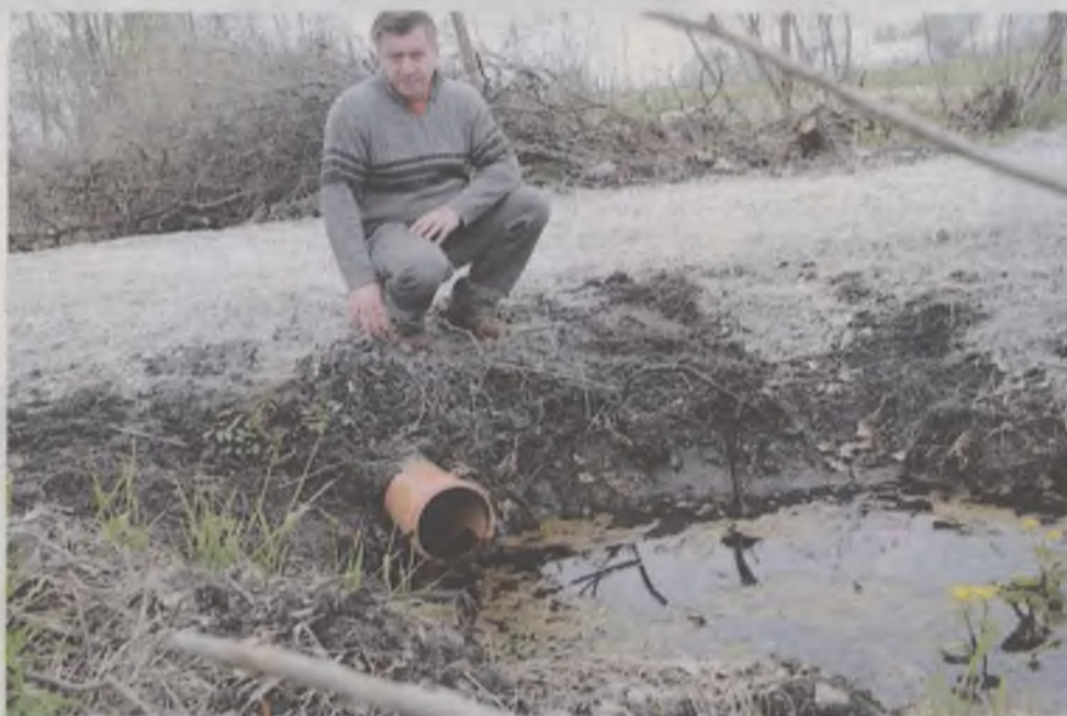
Waldemar Pocałujko twierdzi, że rura, która ma przepuszczać opady na drugą stronę drogi, jest zbyt wąska i przy wyższym poziomie wód nie spełni swojej roli. Wtedy woda zmyje świeżo wysypany tłuczeń
