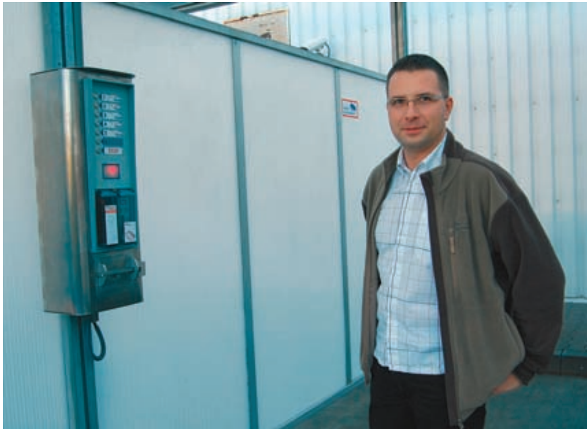
- Wymiana porysowanego panelu kosztowała 1146 zł - mówi Łukasz Dudzic.
