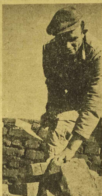
M URARZ Słupski z Warszawy nie pozostaje w tyle. Cegły mijają mu tylko w rękach; buduje przecież dom dla warszawskich robotników. Fof. CAF
