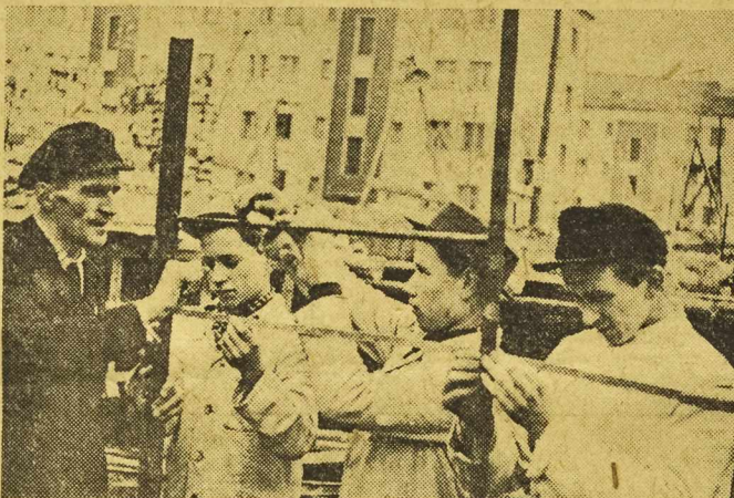
Murarze niemieccy z NRD, pracujący przy odbudowie Berlina, stosują metody radzieckich i polskich murarzy. Na zdjęciu: murarz Walter Tilla przekazuje doświadczenia radzieckie uczniom murarskim z bloku „E — Południe”. (Fot. — CAF)
