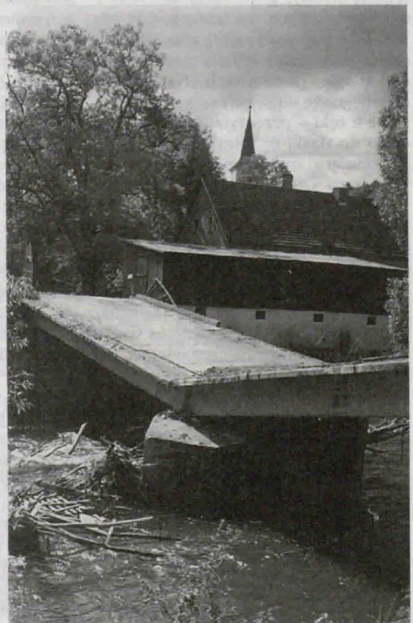
Radochów. Zniszczony most na Białej Łądeckiej Foto: Radosław Siekierzyński
