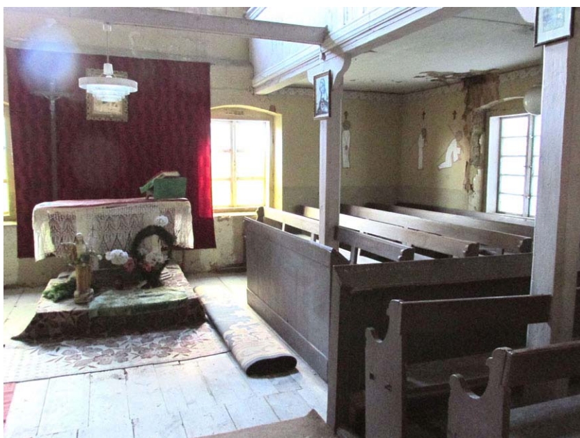
Zdewastowany poewangelicki dom modlitwy – część domu mieszkalnego, w Orlinie
