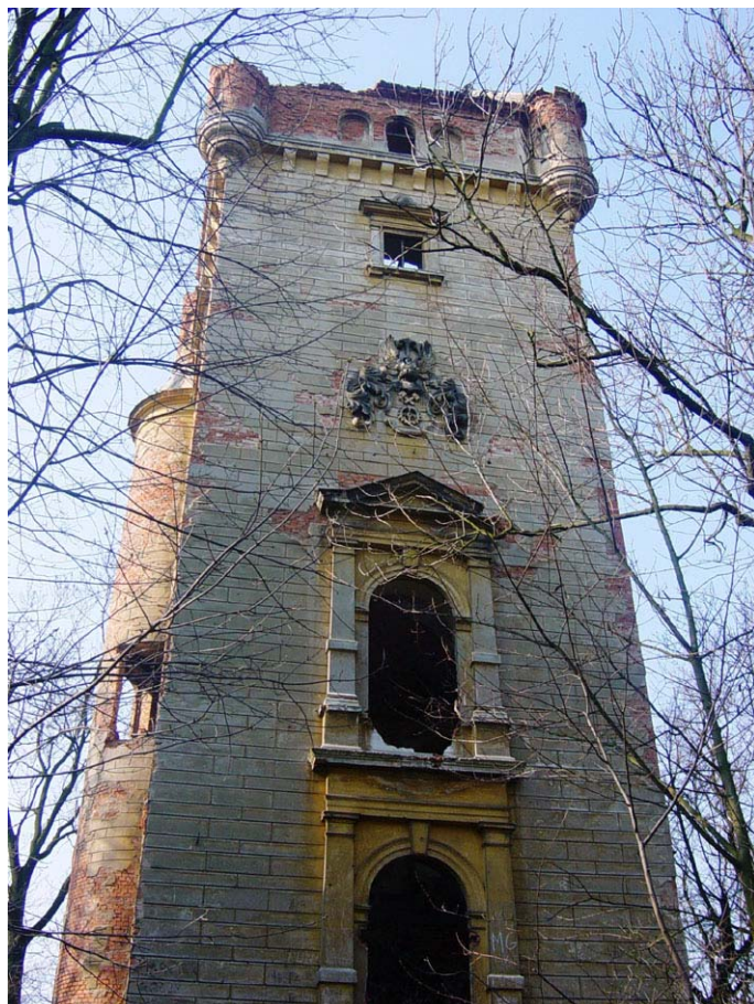
Ruiny wieży pałacu w Chwalimierzu. Fot. Piotr Dacko
