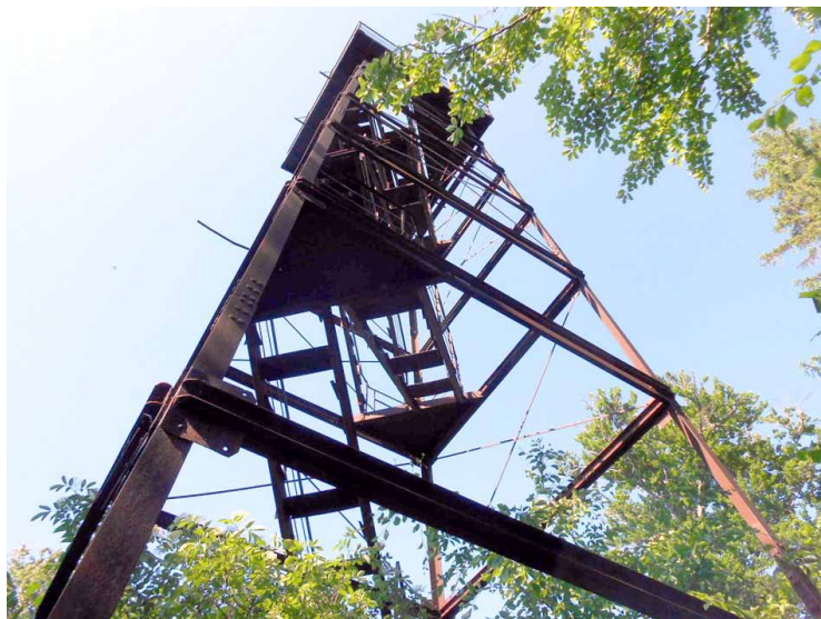
Niedostępna, zdezelowana wieża widokowa na Ostrej Górze
