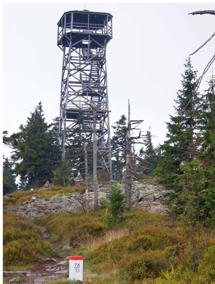
Trójmorski Wierch. Wieża „po przejściach” (V 2014)
