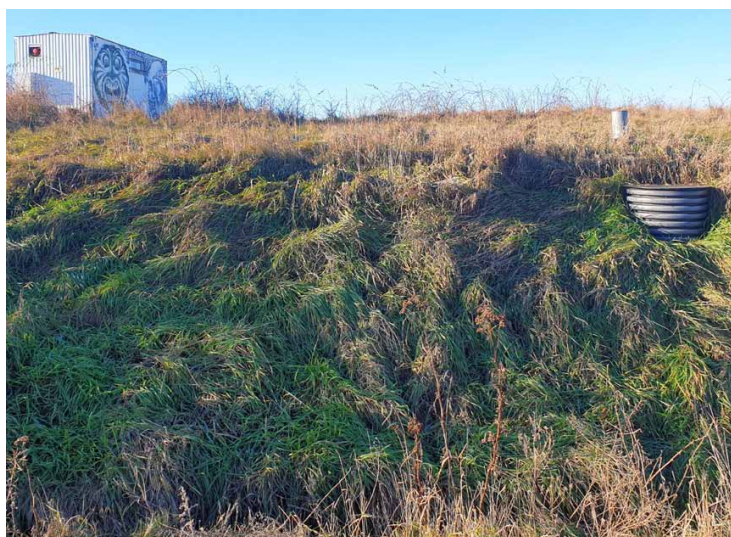
Wzgórze Maślickie. Fragmenty instalacji odgazowujących z kontenerem na szczycie
