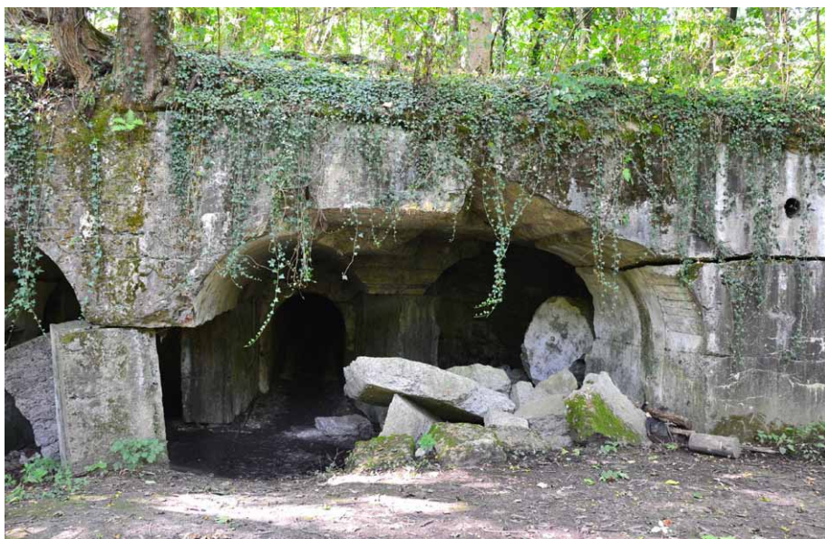
...a część została zniszczona
