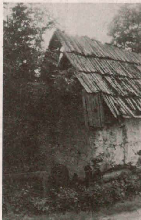
Kacwin – zabytkowe spichlerze też popadają w ruinę, i to przy głównej ulicy. Przez miejscowych uważane są za przykład „dziadostwa”, komu to potrzebne?
