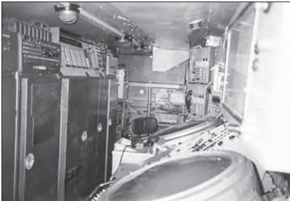
Fot. 8.41. Kabina operatorów systemu „Wozduch-1M”. Obiekt WP-01M
