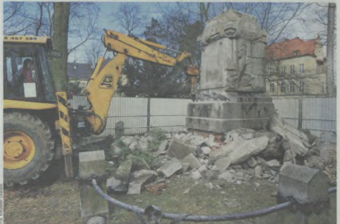
Zniszczenie zabytkowego cokołu było barbarzyństwem
