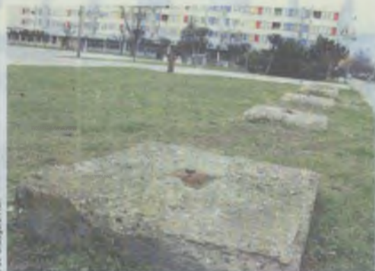
Maszty flagowe groziły zawaleniem
