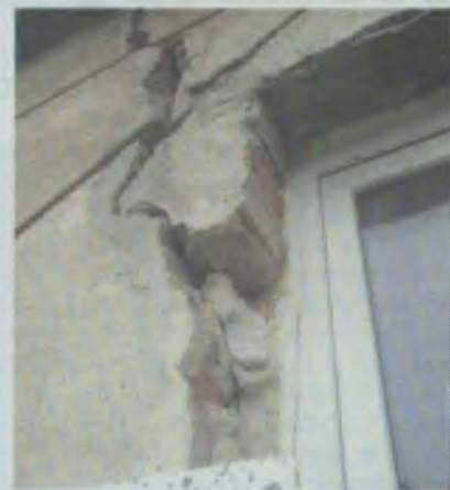
Pęknięć jest coraz więcej
