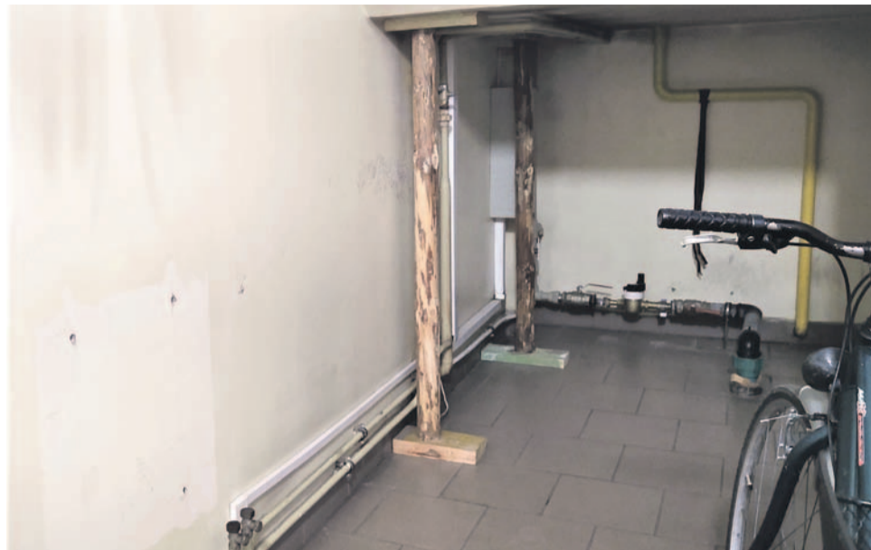
Schody w dobudowanej klatce schodowej przy ul. Młyńskiej podparto stemplami, bo zaczęły odchodzić od budynku, a po kaloryferach został ślad na ścianie
