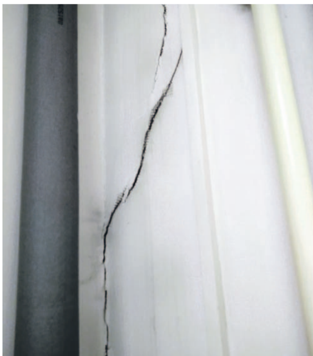
Na ścianach klatki schodowej pojawiły się pęknięcia
