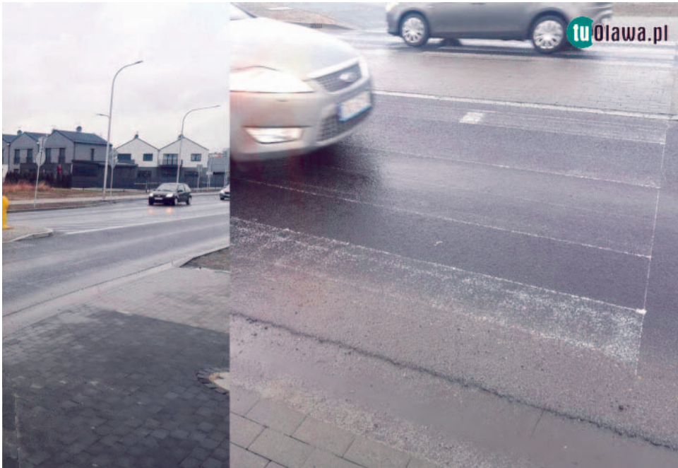
Znikające pasy na przejściach dla pieszych w Jelczu-Laskowicach
