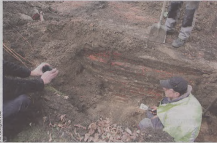
Fundamenty wyglądały solidnie, ale inspektor nadzoru zdania nie zmienia...
