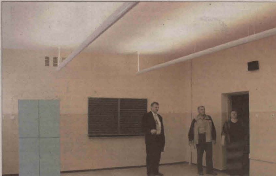
- W tym roku w Szkole Podstawowej nr 2 Państwowa Inspekcja Pracy zaleciła, by wymienić oświetlenie we wszystkich pomieszczeniach lekcyjnych, bo natężenie światła w salach było poniżej wymagań norm. Po wymianie oświetlenie jest wszędzie identyczne, równomierne i bez zaciemnienia, a również oszczędnościowe. Jest to światło rozproszone, o ciepłym kolorze. Natężenie na biurku dziecka wynosi teraz ok. 1100 luksów, a na tablicy 850 - wyjaśnia Ryszard Wyraz
