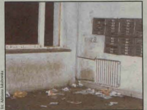
Smieci, brudne ściany, wylamane drzwiczki od skrzynek...
