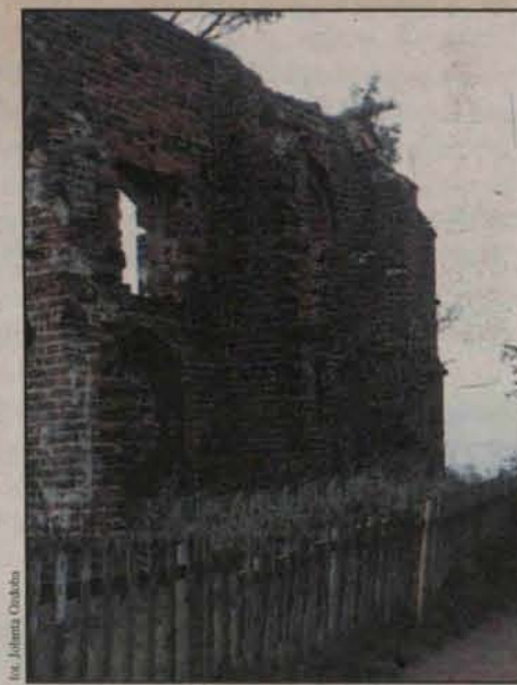
Ostatnia ściana kościoła w Trzęsaczu
