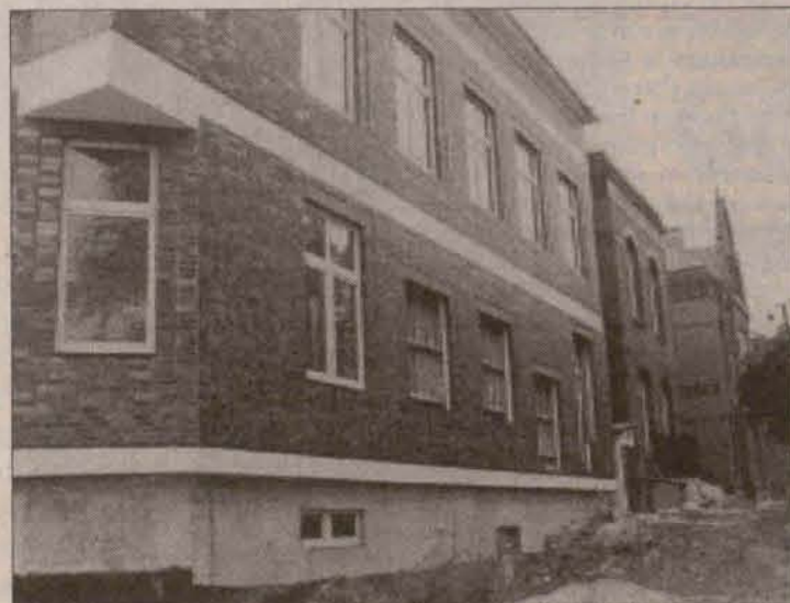
Remont i rozbudowa szpitala pochłonęły 3 mln zł. Dziś okna trzeba było zabić deskami.
