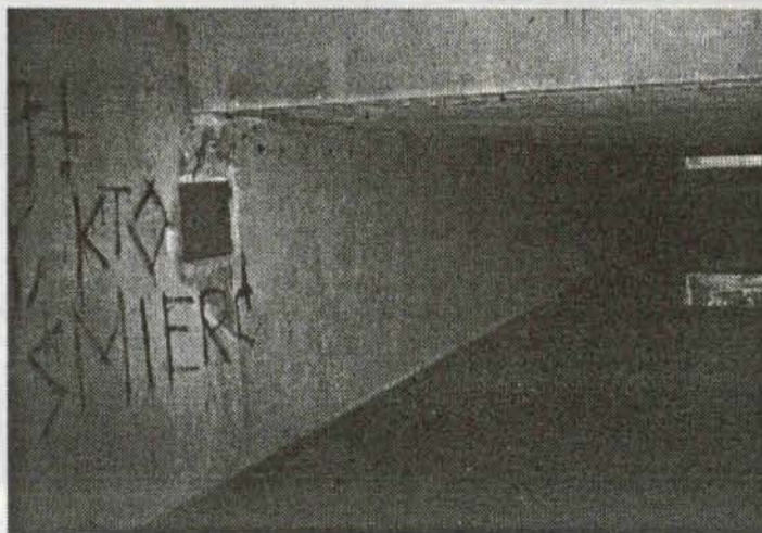
Zalane przejście podziemne pod „dwupasmówką”. Foto.: A. Lech
