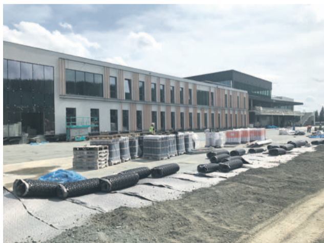
W Dolnośląskim Centrum Sportu trwają obecnie prace wykończeniowe oraz urządzenie terenu wokół budynku
