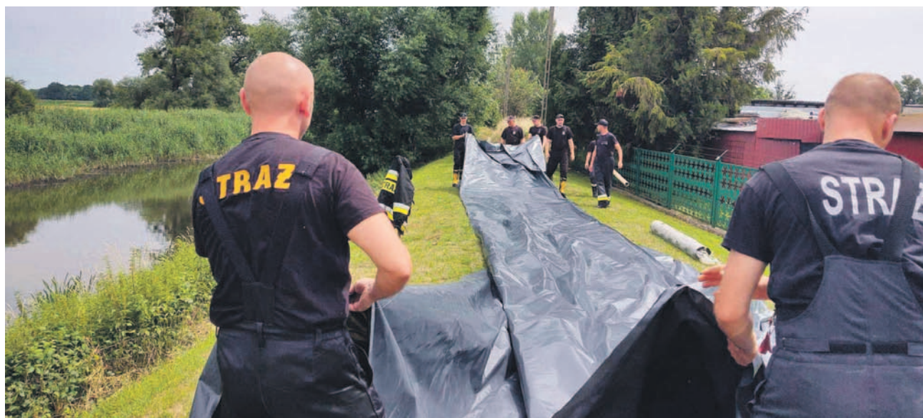
Aby uszkodzony fragment wału nie obsuwał się zbyt szybko w wyniku deszczu, zabezpieczono go folią
