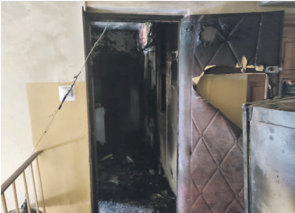
Ogień zniszczył kuchnię i przedpokój
