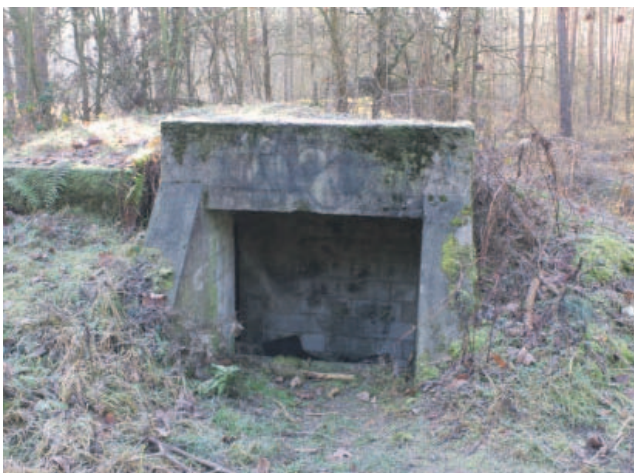
Po częściowym zamurowaniu tego wejścia do schronu nietoperze znajdą w nim spokojne warunki do życia
