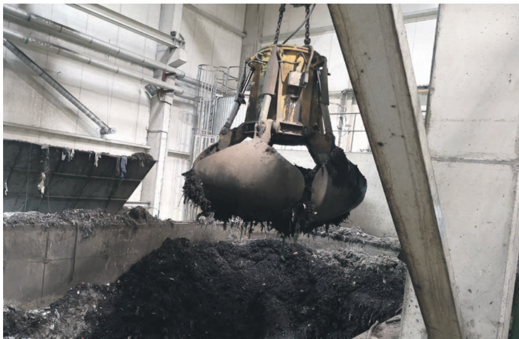
Magazyn wsadu do fermentacji z automatycznym chwytakiem
