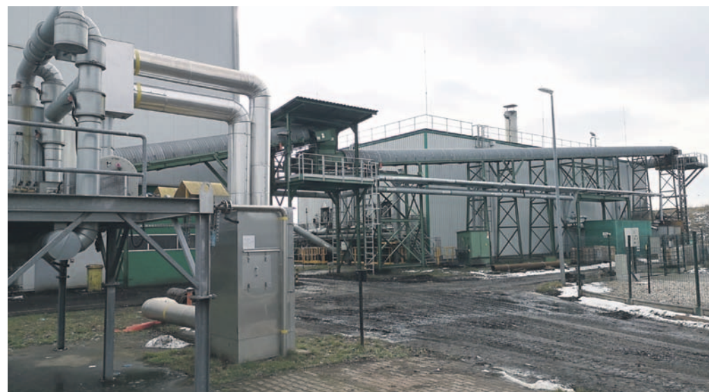
W budynku po prawej są dwie komory fermentacyjne
