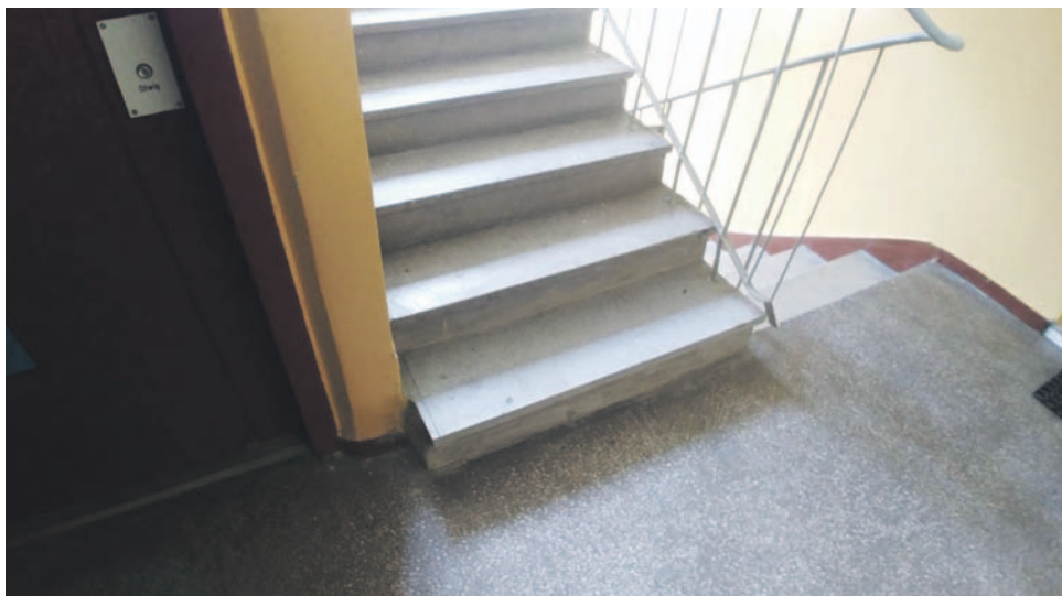
Po wypadku zarządca zlecił naprawę schodów
