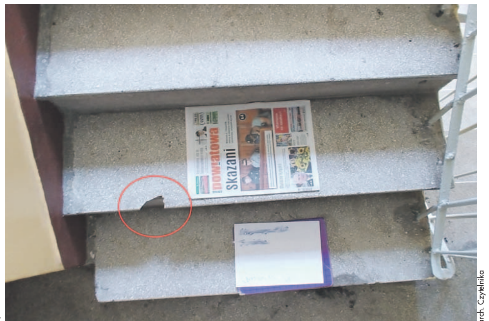
W trakcie trwania procesu Piotr sprawdzał sytuację w innych budynkach, gdzie znalazł sporo niebezpiecznych miejsc. Do określenia momentu zrobienia zdjęcia użył aktualnego wydania „Gazety Powiatowej”
