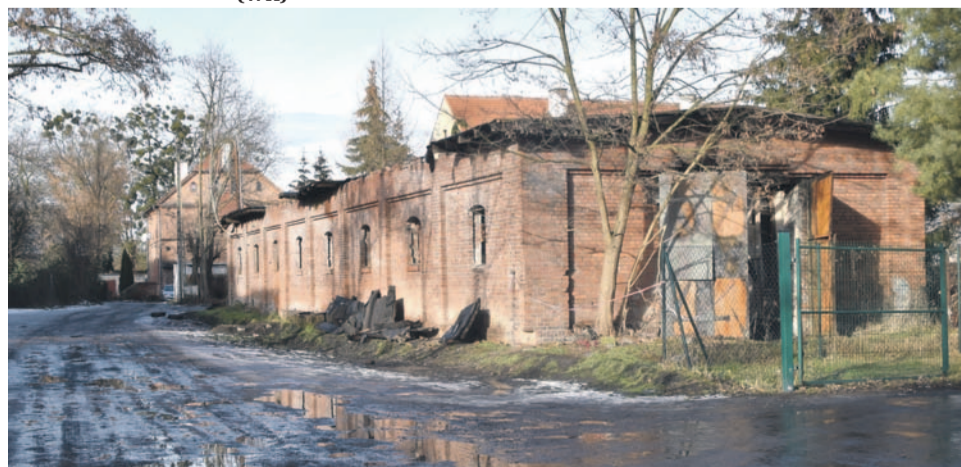
Dawny budynek magazynu wciąż nie został zabezpieczony po pożarze. Mieszkańcy w okolicy boją się, że przez to dojdzie do kolejnego nieszczęścia
