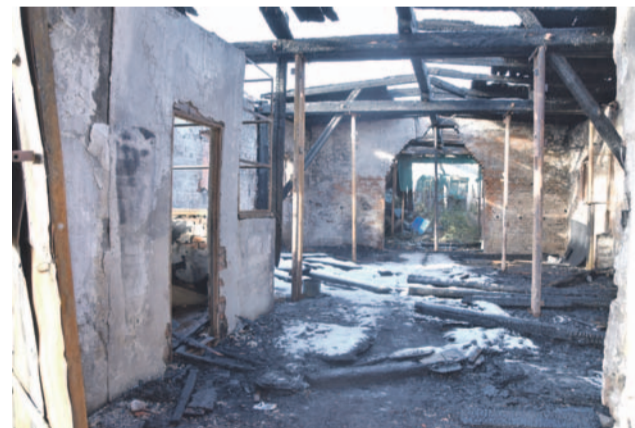
Magazyn ze spalonym dachem
