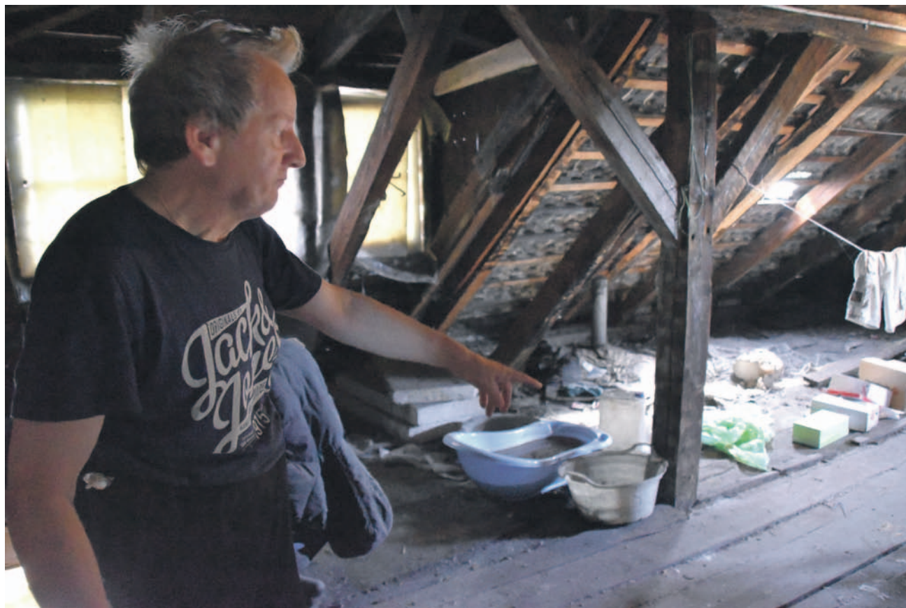
Pan Michał pokazuje miski ustawione pod dziurawym dachem
