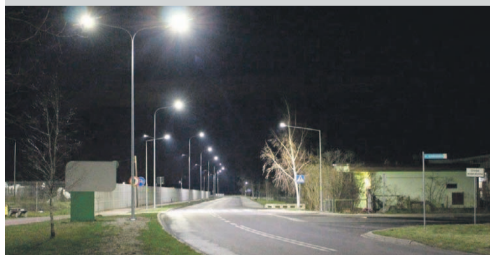
Nowe latarnie zamontowane przy ulicy Ofiar Katynia.
