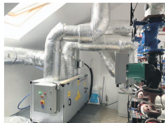
Pompy ciepła ogrzewają nowe mieszkania
