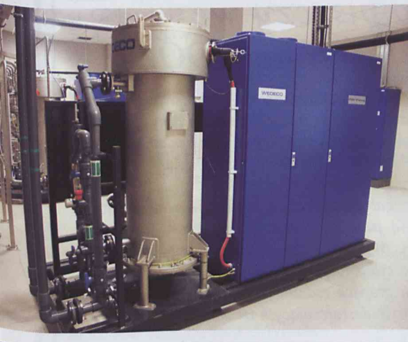
Nowoczesna aparatura do ozonowania wody w zakładzie MPWiK we Wrocławiu
