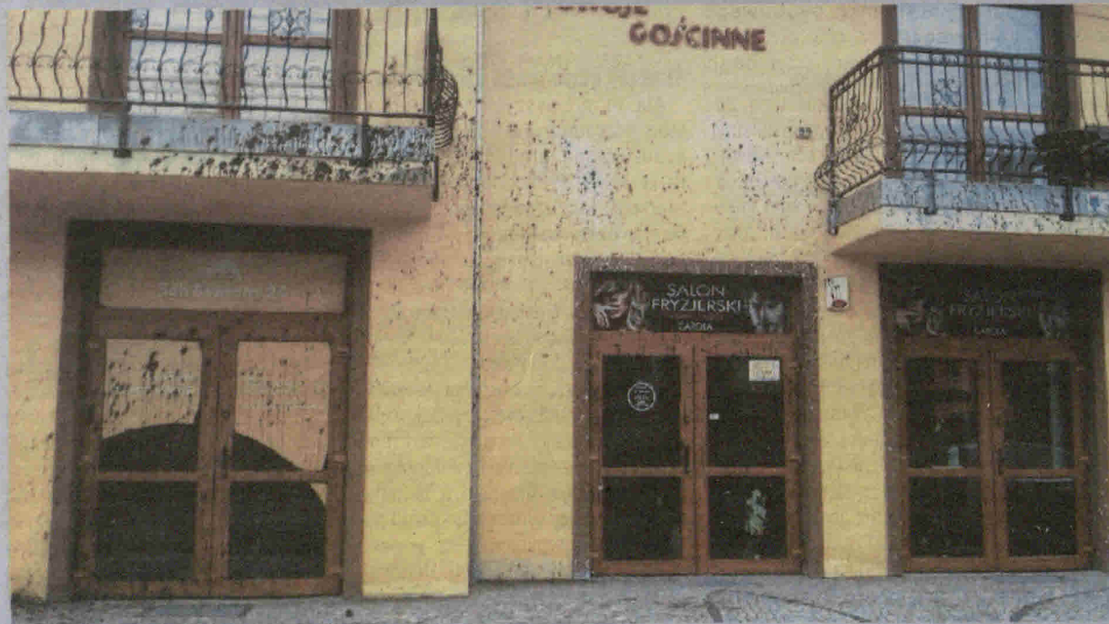
Ostatniej dewastacji pensjonatu Dariusza Delekty niezany sprawca dokonał w Wielką Sobotę.
