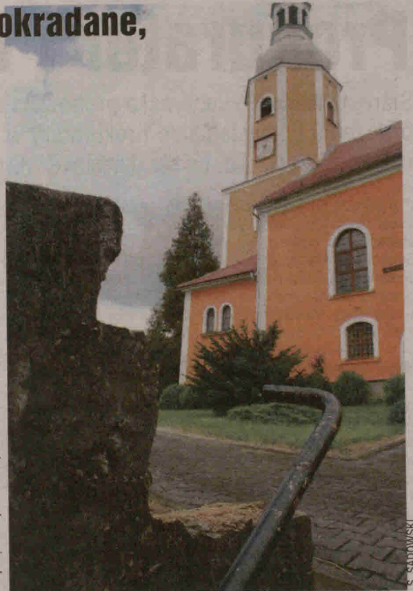
Z otoczenia kościoła w Marczowie zginęły ostatnio elementy z piaskowca. Na zdjęciu zdewastowany element krużganka, z którego zabrano dekoracyjną kulę, rozwalając przy tym kawał muru.
