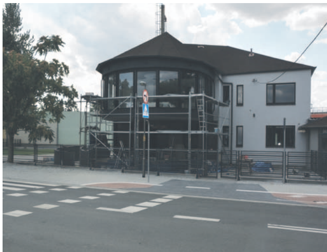
W budynku przy Różanej 8 trwają prace nad adaptacją pomieszczeń dla oławskiego oddziału WORD
