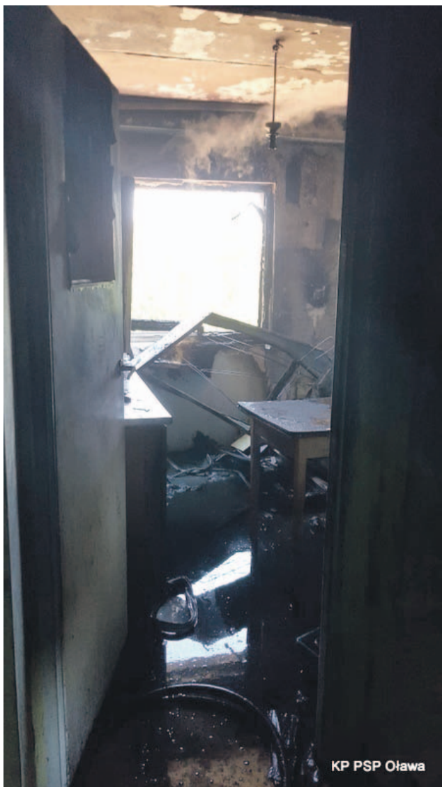
Kuchnia spłonęła doszczętnie. Inne pomieszczenia też wymagają remontu. Na portalu pomagam.pl/wracamydomu trwa zbiórka pieniędzy na odnowienie mieszkania
