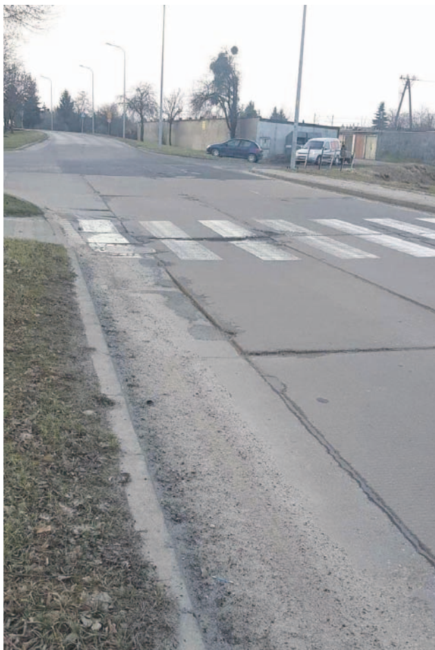
Ta droga na pewno wymaga remontu. Mieszkańcy narzekają, że nie mogą spać przez hałas spowodowany stanem nawierzchni
