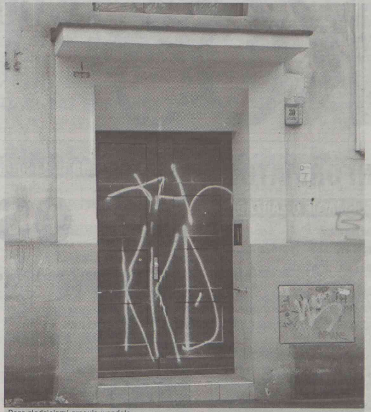
Poza złodziejami grasują wandalę.
