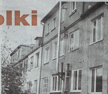
Nie trzeba być konserwatorem zabytłoc, żeby stwierdzić, że to rury wyjątkowo szpetną bryldę i niszczą urok całego fragmentu osiedla.
