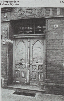
Brama przy ul. św. Antoniego przed renowacją
