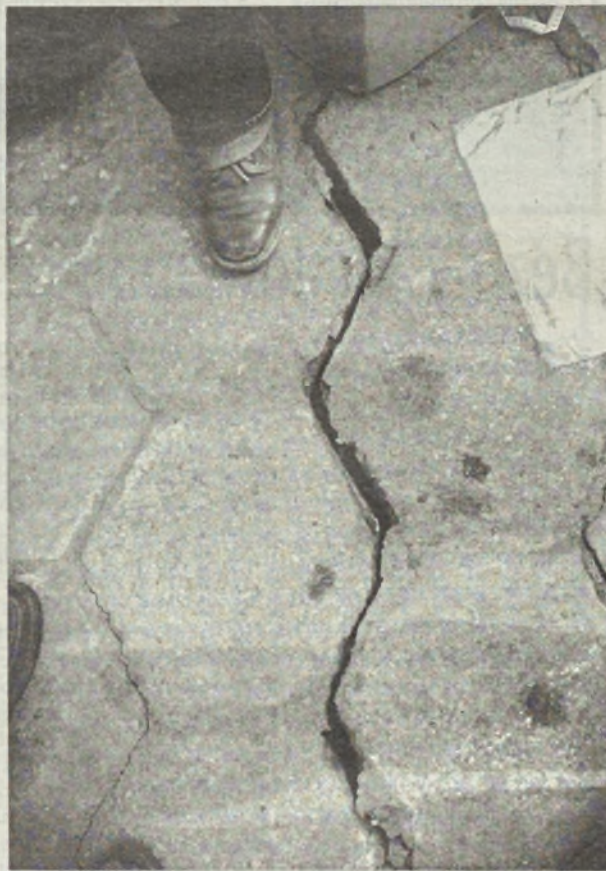
Pęknięcia chodnika na bazarze 5 metrów od budowy.
