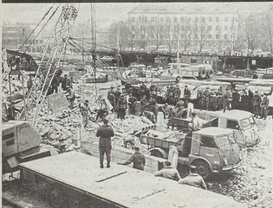
W odgruzowywaniu zawałonego budynku przy placu Grunwaldzkim, pomagało wojsko. W katastrofie zginęło 10 robotników z Wrocławskiego Przedsiębiorstwa Budownictwa Przemysłowego nr 1.
