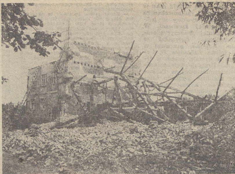
Trwa rozbiórka spalonego młyna. W widocznej na zdjęciu ocalałej po wyburzeniu części projektuje się urządzenie specjalistycznej przychodni międzyzakładowej.
