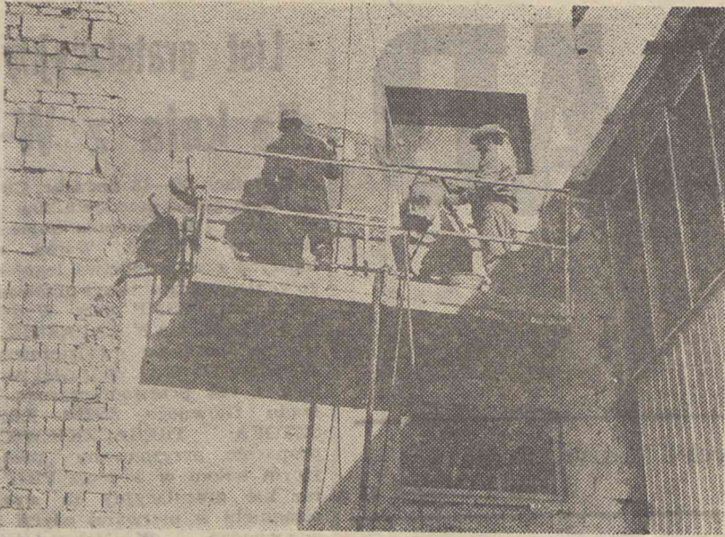
Trwają ostatnie prace przy budynku Zasadniczej Szkoły Zawodowej ZKIMR. Na zdjęciu: Ekipa tynkarzy.
