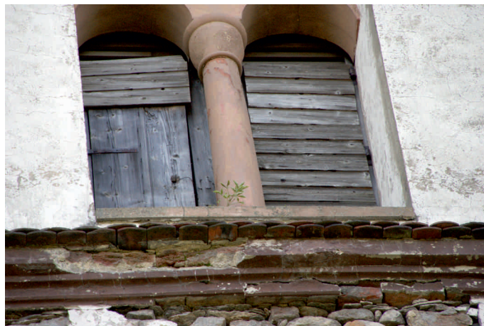
Elewacja przed remontem była w bardzo złym stanie.
