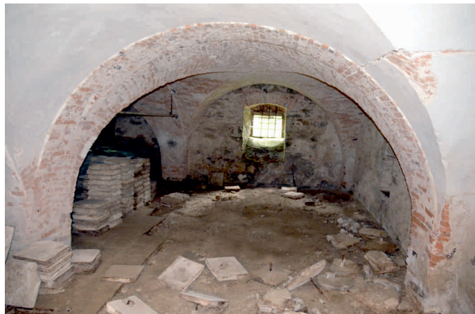
Piwnice browarne też wkrótce czeka remont
