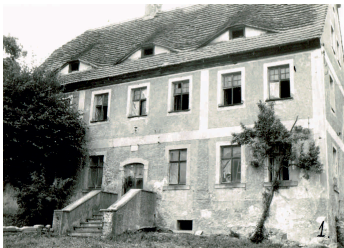
W roku 1994 budynek był raczej w opłakanym stanie
